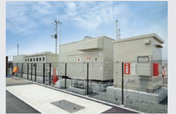
バイオディーゼル非常用発電機(500kVA)
